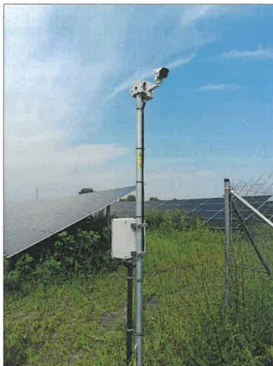
Zdjęcie 13 Monitoring wizyjny
