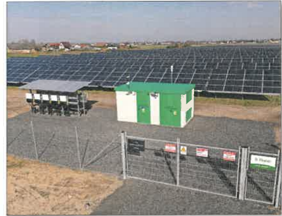
Zdjęcie 6 Inwerter – montaż odrębnie
