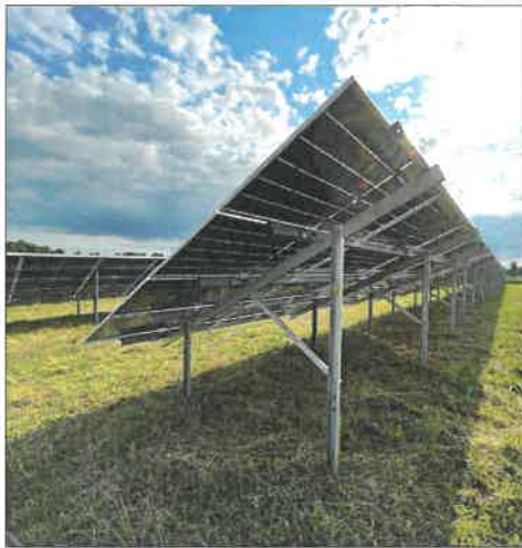
Zdjęcie 3 Konstrukcja wsporcza
