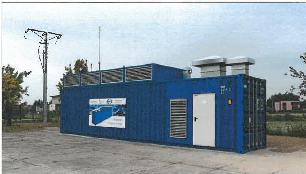
Zdjęcie 9 Przykład magazynu energii
