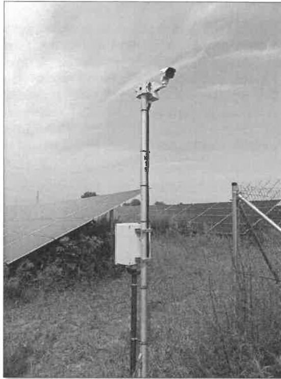
Zdjęcie 13 Monitoring wizyjny
