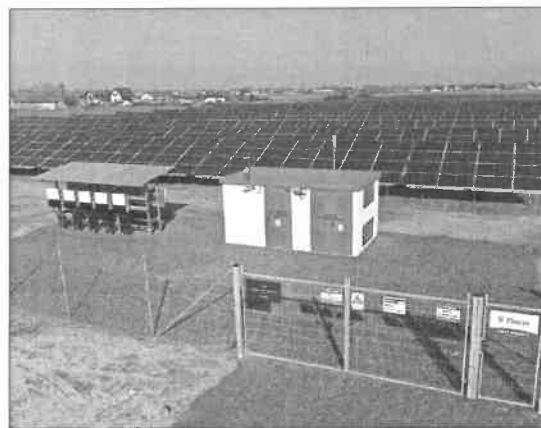
Zdjęcie 6 Inwerter – montaż odrębnie
