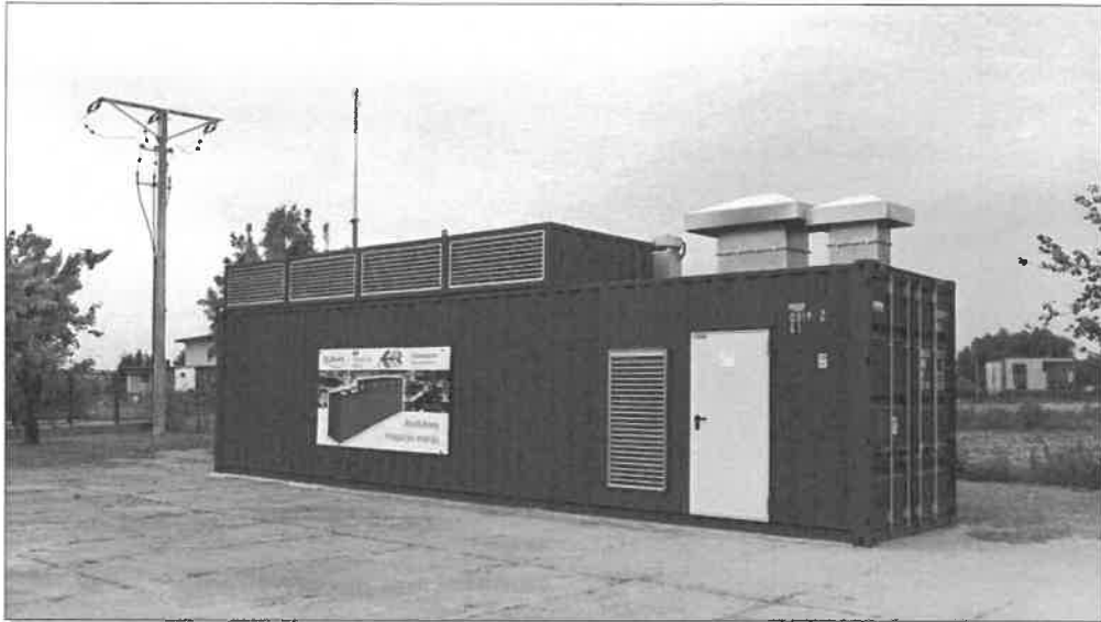
Zdjęcie 9 Przykład magazynu energii
