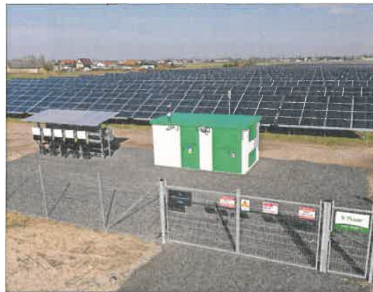
Zdjęcie 6 Inwerter – montaż odrębnie
