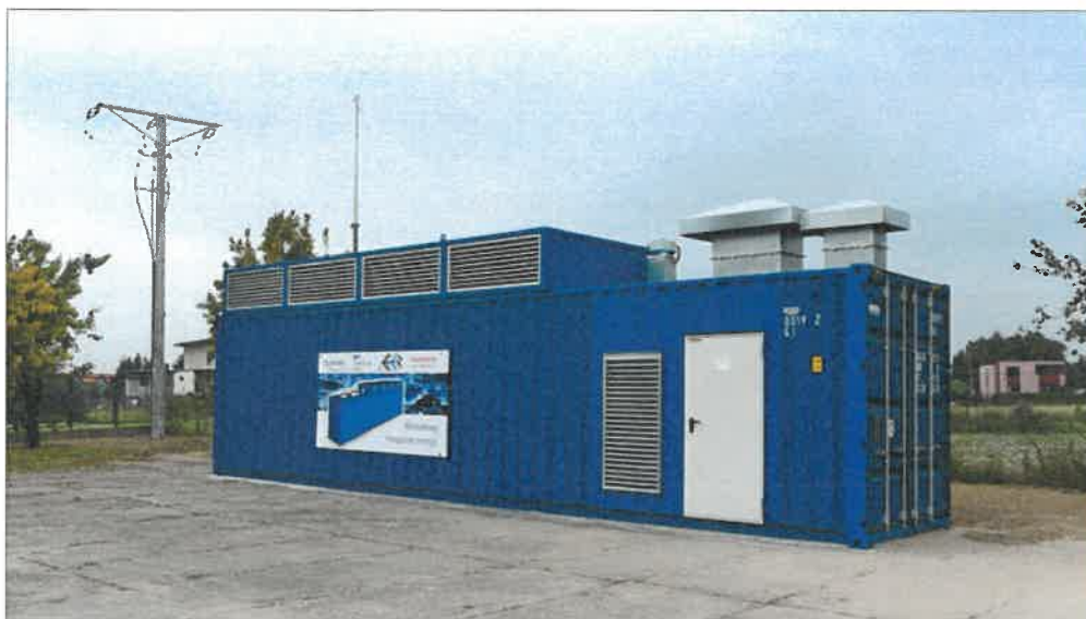
Zdjęcie 9 Przykład magazynu energii
