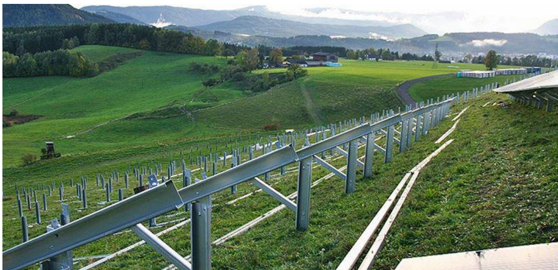
Zdjęcie 3. Konstrukcja przeznaczona do posadowienia paneli fotowoltaicznych.
