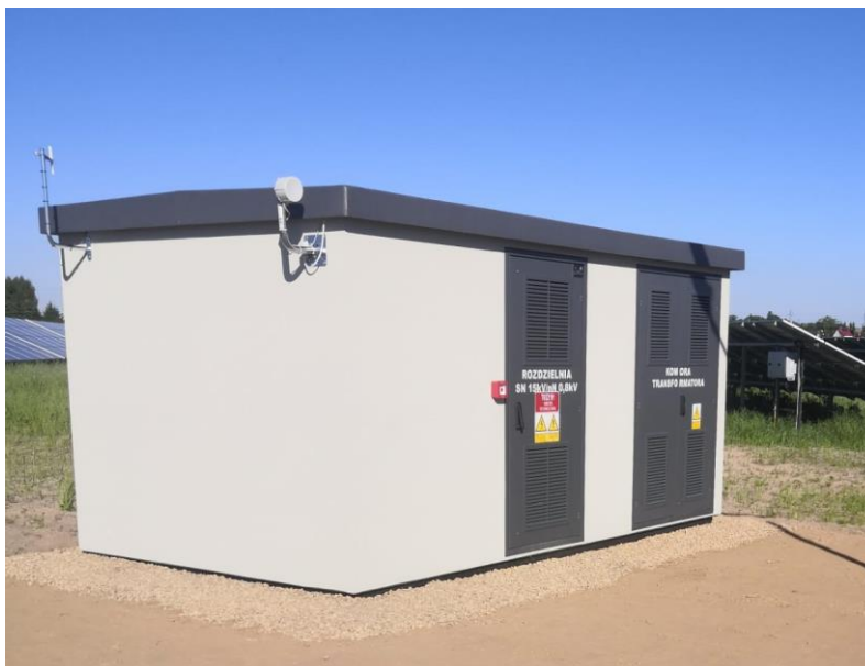
Zdjęcie 9. Przykładowa kontenerowa stacja transformatorowa Źródło: wykonanie własne.
