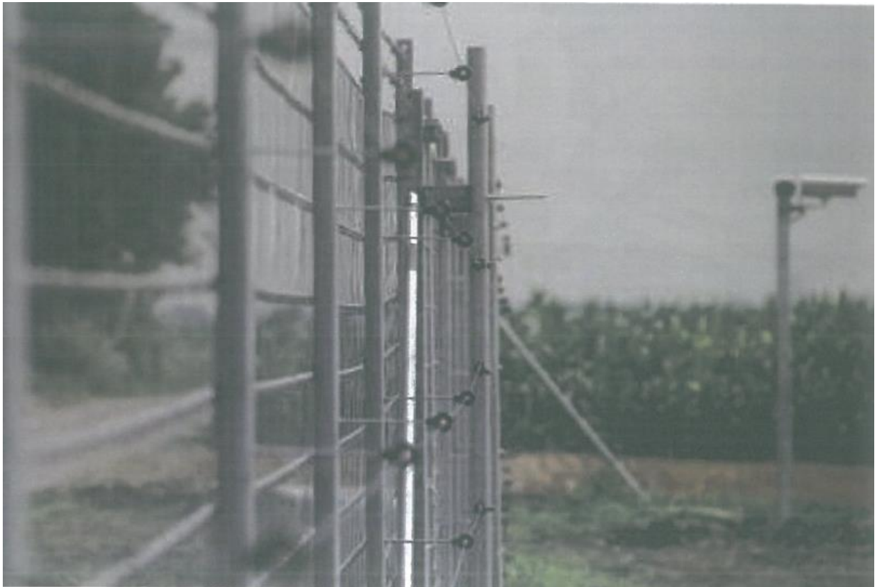
Rysunek 8: Przykładowe ogrodzenie farmy fotowoltaicznej
