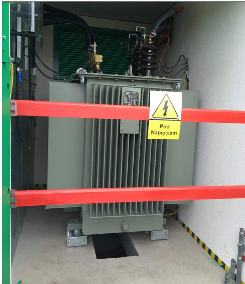
Zdjęcie 8 Otwór w posadzce
