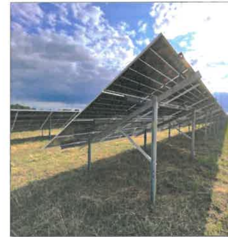
Zdjęcie 3 Konstrukcja wsporcza
