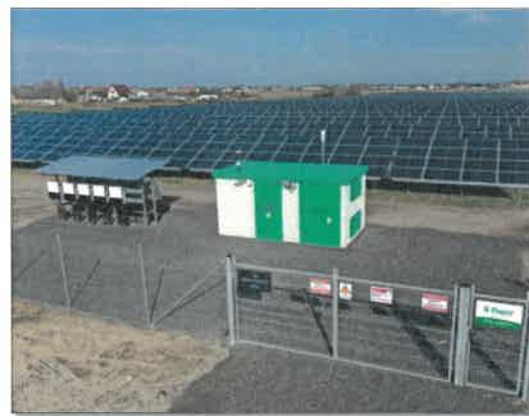
Zdjęcie 6 Inwerter – montaż odrębnie
