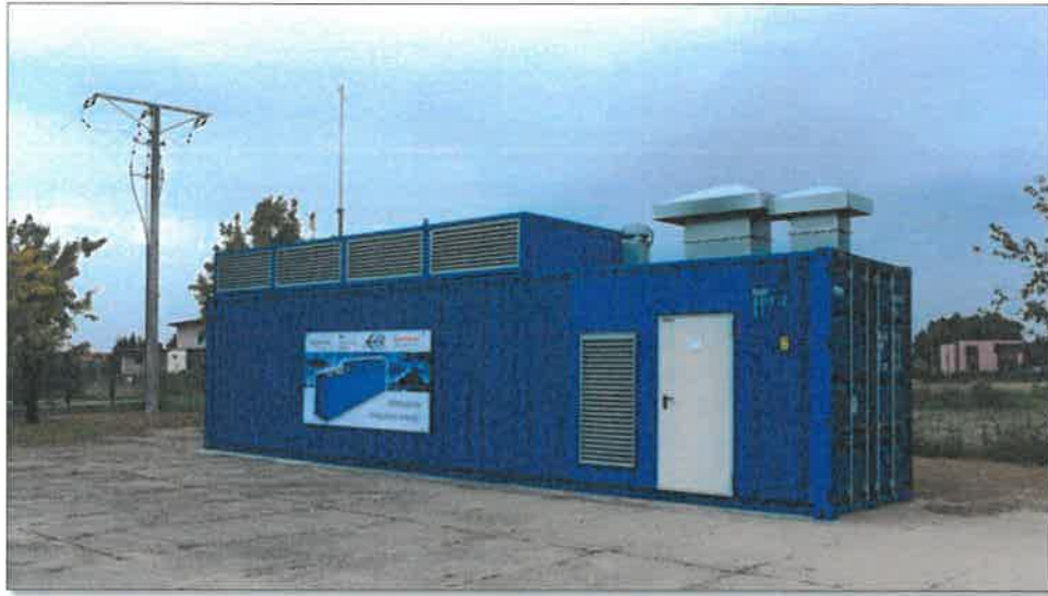
Zdjęcie 12 Przykład magazynu energii
