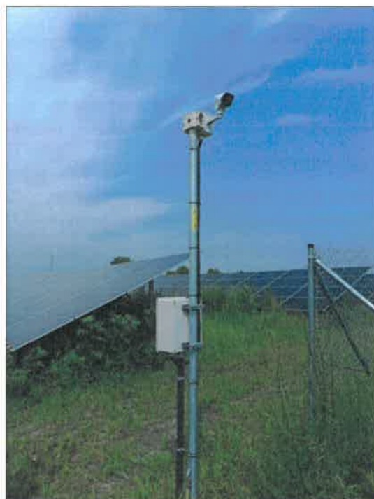
Zdjęcie 16 Monitoring wizyjny
